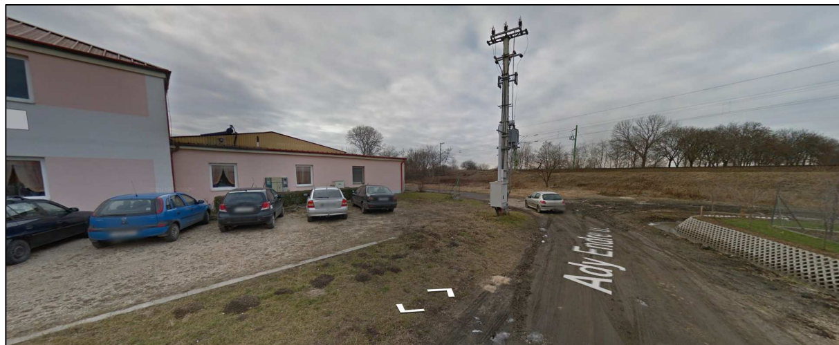
Meglévő transzformátor állomás az Ady Endre utca-Kökény utca csatlakozásánál /Forrás: KIRA Street View/
